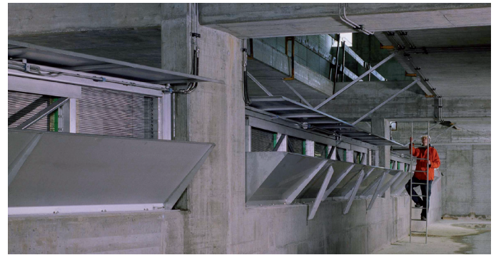
Einlaufkanal der ARA Aire in Genf, 3 RSW10X8/4, Q max. gesamt = 18'000 l/s Ansicht vom Entlastungskanal
