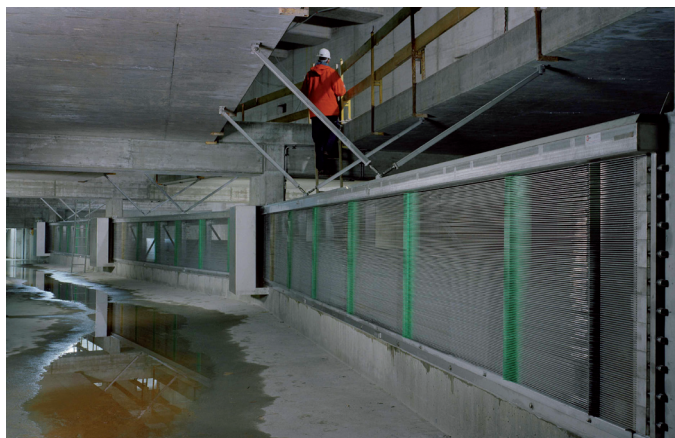
Montaggio di griglie a setaccio nell'impianto di trattamento delle acque di scarico a Ginevra
