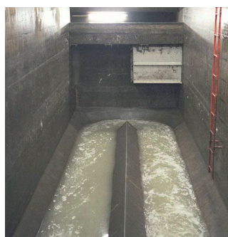
ID Zürich-Wollishofen, metà destra bacino con pozzetto di raccolta materiale sgrigliato sullo sfondo. Il setaccio RSU ROMAG è montato dietro alla soletta di calcestruzzo.
