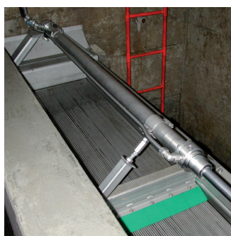
Setaccio RSU ROMAG. Lato di scaricamento con cilindro idraulico e carrello di lavaggio. La soletta in calcestruzzo provvede allo scarico di emergenza.
