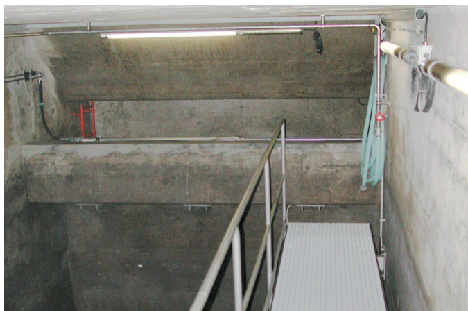
ID Zürich-Wollishofen, metà sinistra del bacino, setaccio RSU ROMAG sullo sfondo. Il condotto idraulico per il cilindro è ben visibile. Il cilindro idraulico si intravede al di sopra del bordo della muratura.
