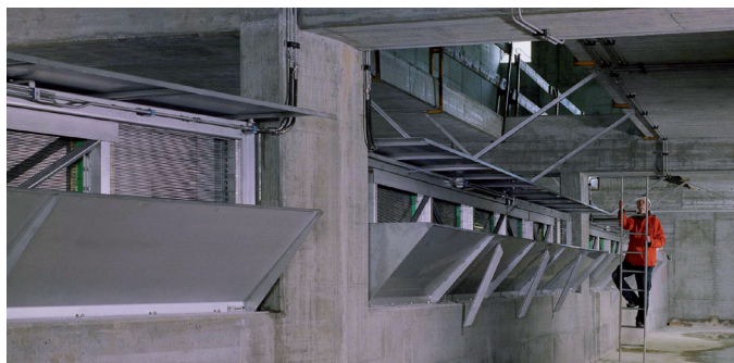
Canale dello scaricatore di piena dell'impianto di depurazione (ARA) Aire a Ginevra, 3 RSW10 X 8/4, Q max .totale =18,000 l/s Vista del canale dello scaricatore di piena
